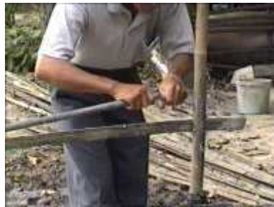
Photo 43. Connexion du tuyau de distribution du gaz au support
